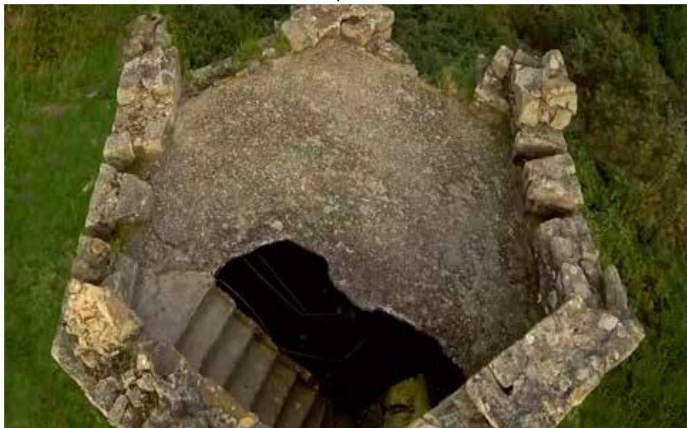
Vista superior en la que se aprecia el forjado de hormigón y la escalera interior realizada probablemente a mediados del siglo XX.
